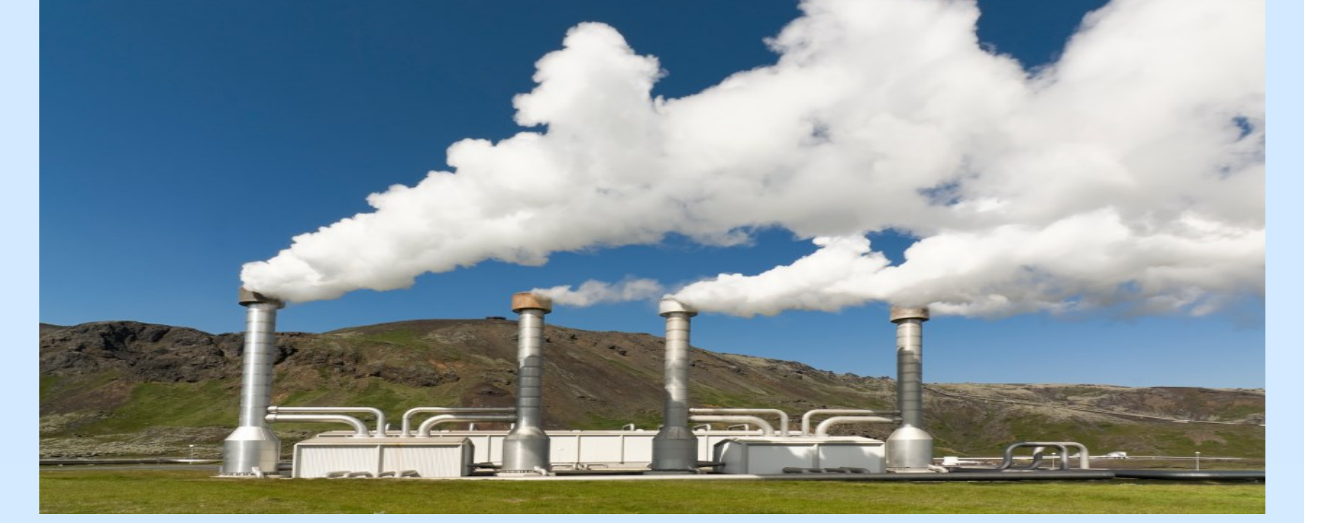
Şekil 3. Jeotermal enerji santrali
